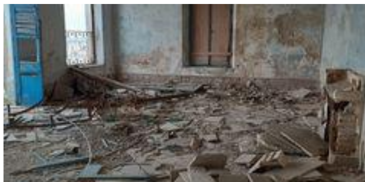
Fig.8. Revêtements arrachés des parois du mirador 12 .
