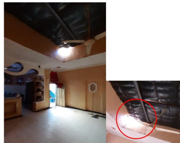
Fig.16. Patio couvert par un film en plastique noir avec démolition totale des piliers et des arcs, Source : auteurs, 2022.
