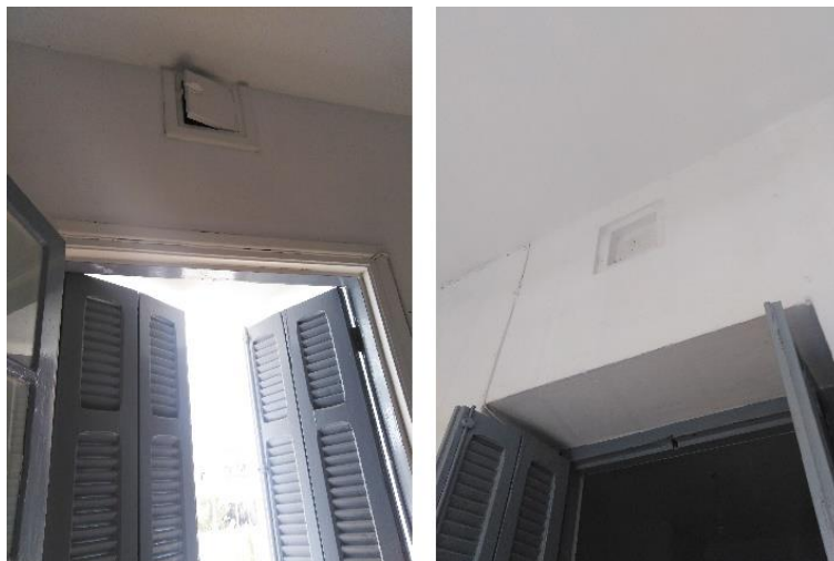
Fig.22. Percement haut présent au-dessus des ouvertures des pièces de l'appartement du « Zodiaque ». Source: photos de l'auteure, 2020.
