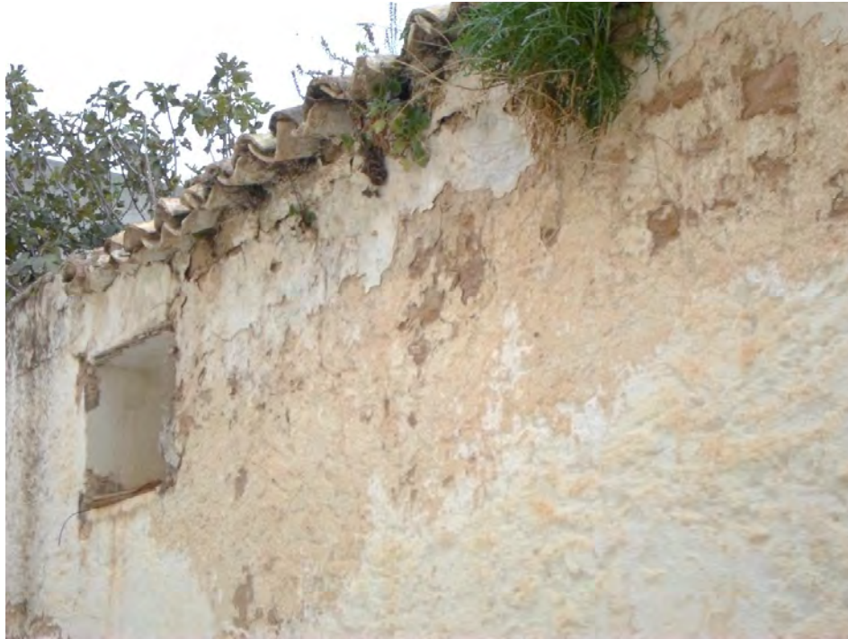
Fig. 27. Quelques traces d'une couverture en tuiles creuses qui protégeait une vieille maison à Tébourba.
