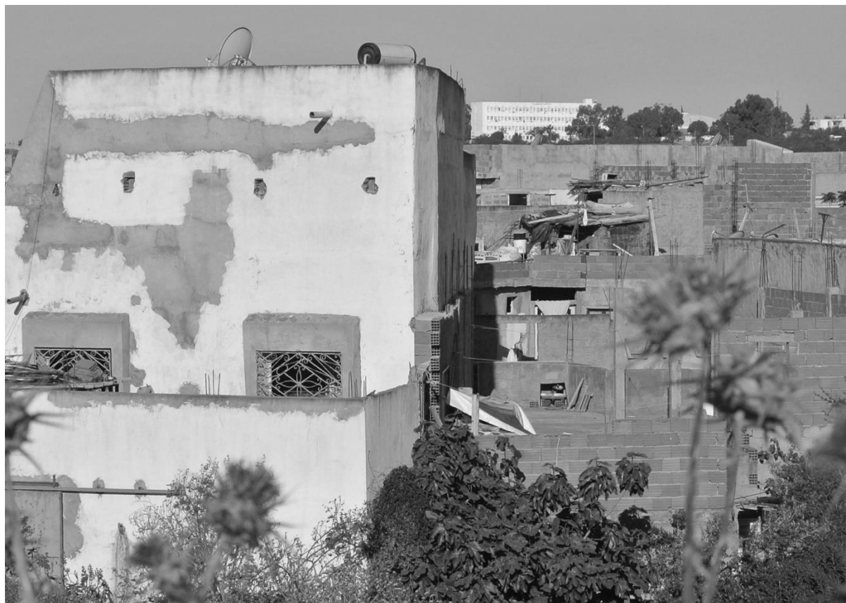
Fig. 29. Fragment de façade extérieure du bidonville. La majorité des habitats sont en état de chantier. Ils sont, en l'occurrence, habités.
