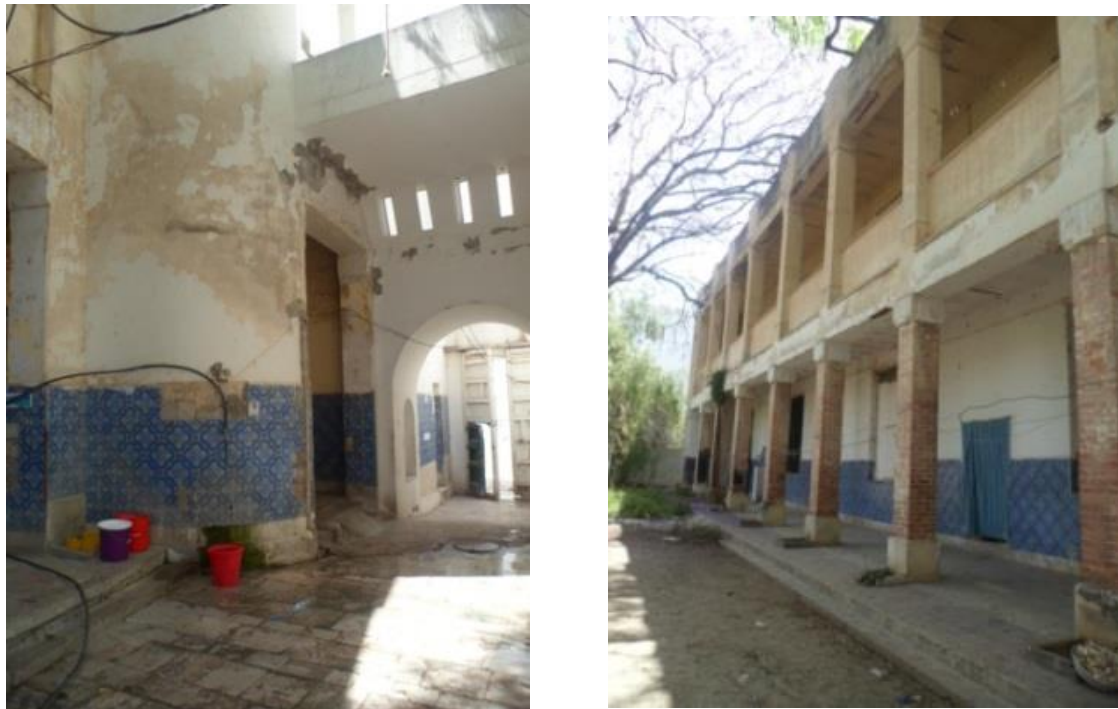
Fig. 8. Etat de l'école israélite gravement endommagée. Une large frise de carreaux italiens de type CE 34 et CE304 garnit la cage d'escalier et la façade principale.
