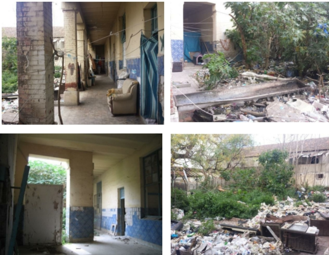
Fig. 1. L'état de dégradation de l'école oukalisée .
